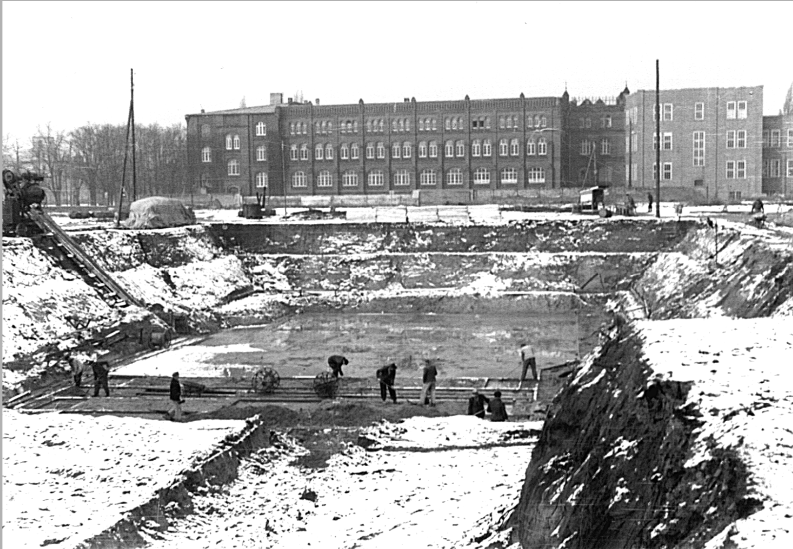
Hannover, Verwaltungsgebäude Continental AG, 1952/53 Königsworther Platz 1, Blick von Osten in die Baugrube, 1952
